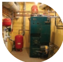
impianti di riscaldamento
