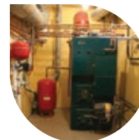
impianti di riscaldamento
