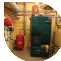
impianti di riscaldamento
