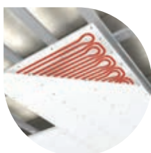
pannelli radianti a soffitto
