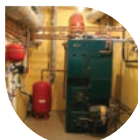
impianti di riscaldamento
